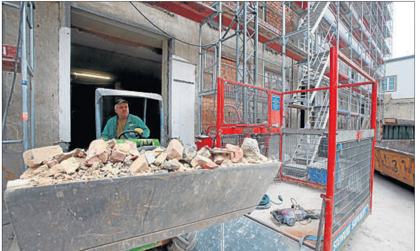
Wird abgerissen: Das Gebäude für den naturwissenschaftlichen Unterricht an der Heinrich-Schütz-Schule ist so marode, dass es abgerissen werden muss. Durch die Stemmarbeiten hatten Schüler und Lehrer mit Lärm und Staub zu kämpfen. Foto: Herzog
